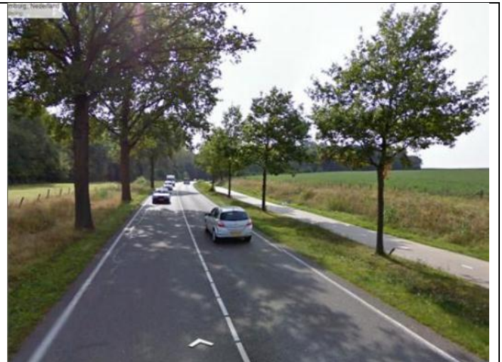
Minimale GOW. NB: de obstakelvrije ruimte voldoet hierbij nog niet aan de minimum-eis.
